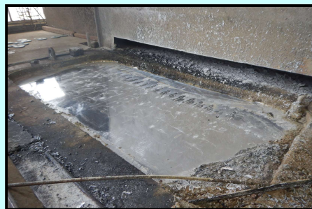
亜鉛めっき槽
